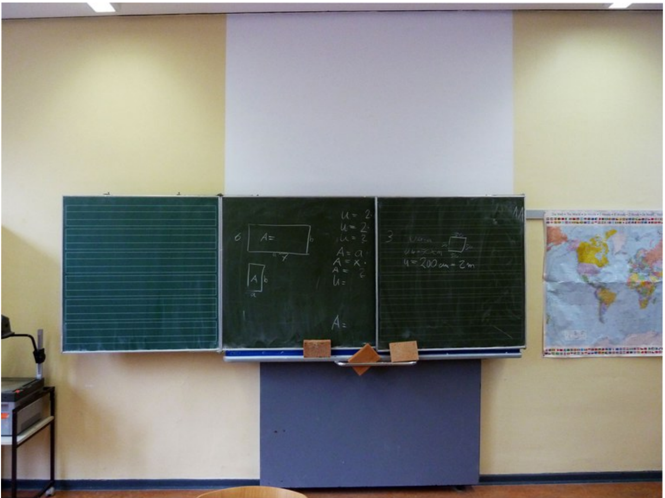
Nicht ausreichende Beleuchtung der Tafel
